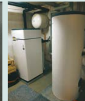
Wärmepumpe und Wärmespeicher stehen im Heizungsraum.
