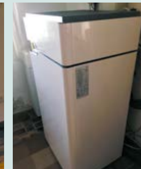
Wärmepumpe und Wärmespeicher stehen im Heizungsraum.
