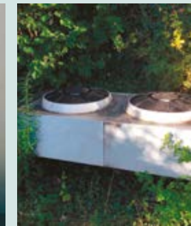
Die Außeneinheit befindet sich im Garten.
