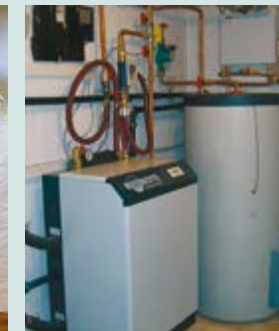
Wärmepumpe und Wärmespeicher stehen im Heizungsraum.
